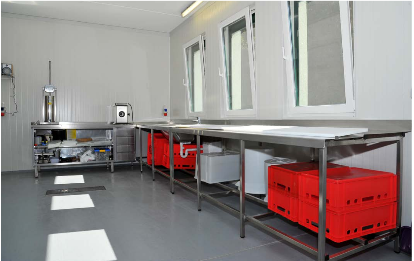
Die saubere hygienische Verarbeitung im Schlacht- und Verarbeitungsraum garantieren beste Qualitätsergebnisse.
